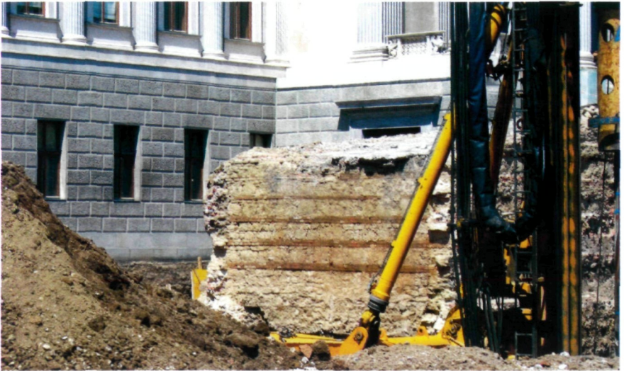
12 Schichtenmauerwerk unterhalb der Rampe des 1873-1883 erbauten Parlamentsgebäudes in Wien, freigelegt und teilweise abgetragen 2004
