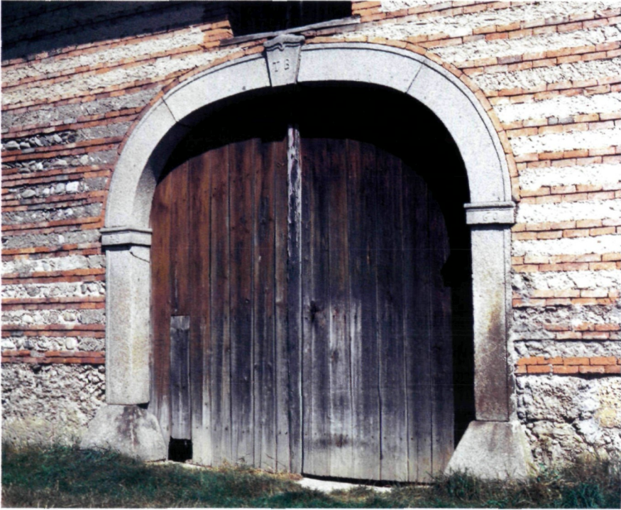
9 Einfahrt im Schichtenmauerwerk mit Gewände aus Werkstein, datiert 1860, aus Hofkirchen bei St. Valentin (NÖ)
