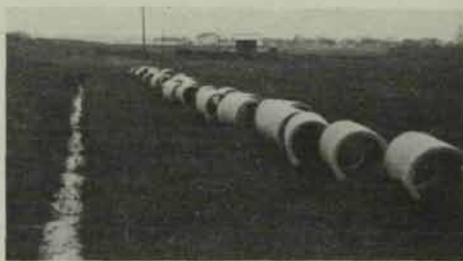
Störendes Gerinne wird „beseitigt“.
